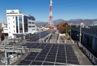
山梨営業部に設置した太陽光発電設備
